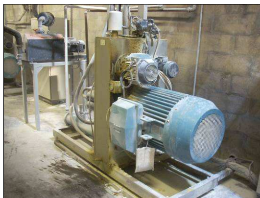
Figure I - 12 : Pompe à vide
